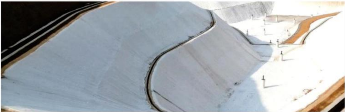
榆林市麻黄梁工业固废项目
